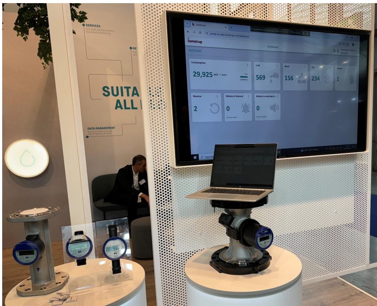
Kamstrup vízmérők és Leak detector rendszer
